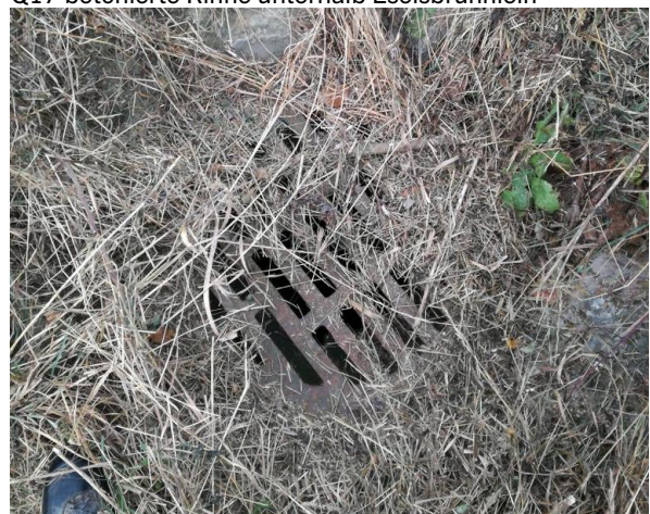
Q20 Gully der Rohrleitung Richtung Eselsbrunnlein
